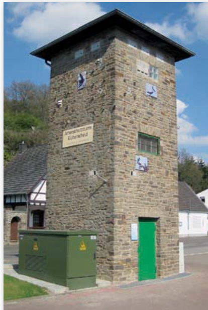
Abb. 7: Trafoturmstation Eicherscheid (Artenschutzurm).
